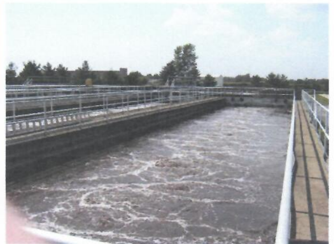
บ่อบำบัดน้ำเสีย
