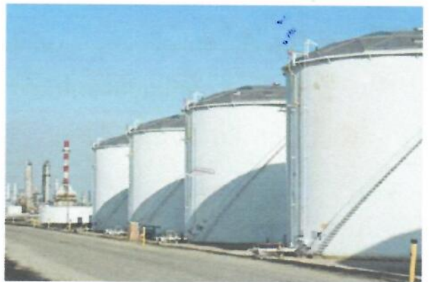
ถังเก็บน้ำมันบนดิน
