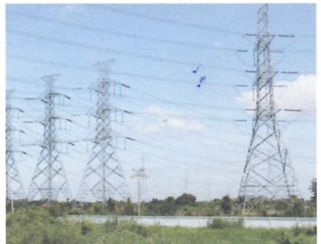
เสาไฟฟ้า
